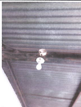
Foto1: SUSTITUCION DE BOMBILLAS, POR BOMBILLAS LED CIRCULAR 12W DL TECNO LITE 12CIRLED65MV
